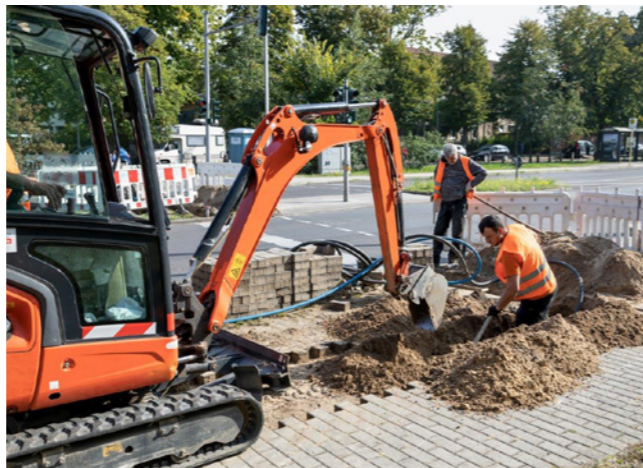
Solche Kabelverlegearbeiten werden in den kommenden Jahren in den SWGD-Quartieren häufiger zu sehen sein.
